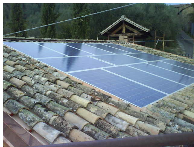
Impianto fotovoltaico integrato
